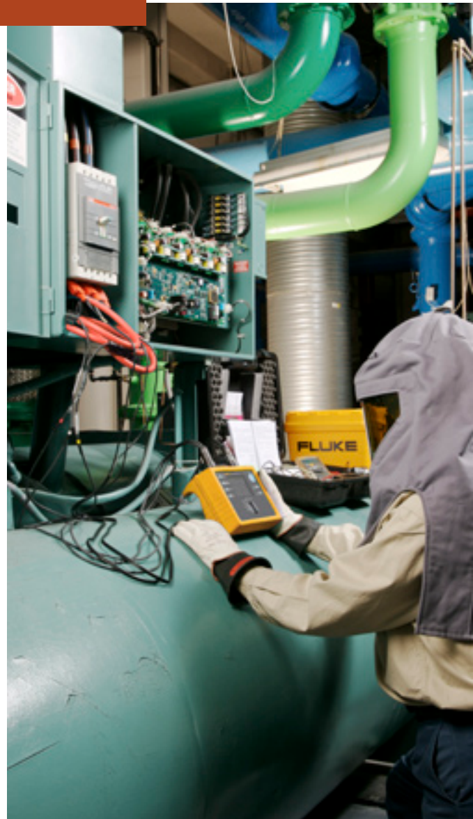
Mithilfe des Power Loggers Fluke 1735 kann die Leistungsaufnahme eines Kühlgeräts gemessen werden, um den Gerätewirkungsgrad festzustellen.
