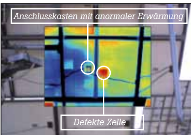
Wärmeprobleme in der Zelle und im Anschlusskasten
