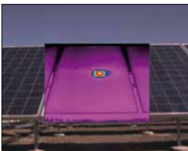
Ein Solarmodul mit einer defekten Zelle
