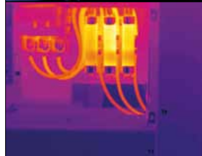
Wärmebilder, die fehlerhafte Anschlussstellen zeigen
