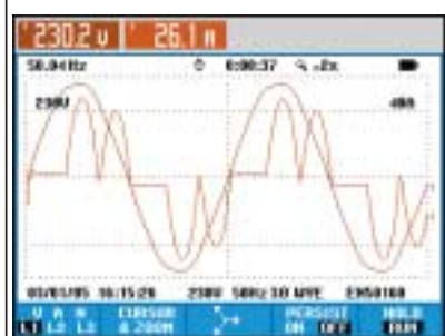
Abb. 4c - Spannung und Strom von Phase L1 zeigen deutlich den verzerrten 'Doppelimpuls'-Strom, der hohe fünfte und siebte Oberschwingungsströme verursacht.
