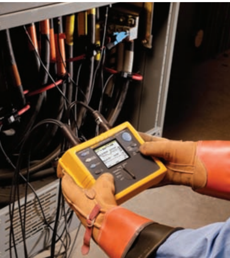
Einrichten des Fluke 1735 Power Logger an der Einspeisung der Energieversorgung für eine 30-Tage-Lastgangstudie
