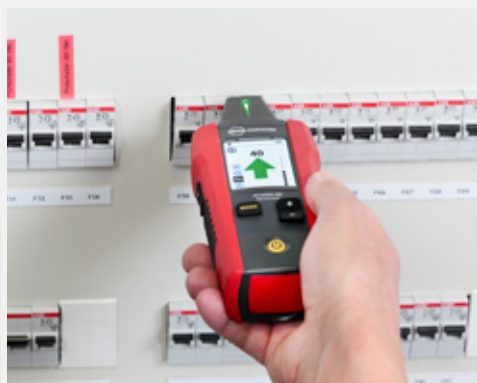
Zuordnung des richtigen Leitungsschutzschalters/Sicherung
