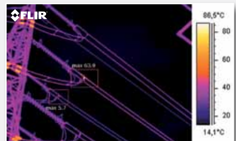
Wärmebildaufnahme mit 640 x 480 Pixeln Auflösung und < 45mK Wärmeempfindlichkeit. Beachten Sie, dass die heiße Stelle jetzt klar erkennbar ist und wie die höhere Pixelzahl eine noch genauere Temperaturmessung in der heißen Stelle möglich macht. Jetzt ist klar, dass die Ursache des Problems in der Hochspannungsleitung liegt.
