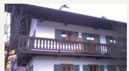
Fehlerhafte Isolierung über Balkonfenster
